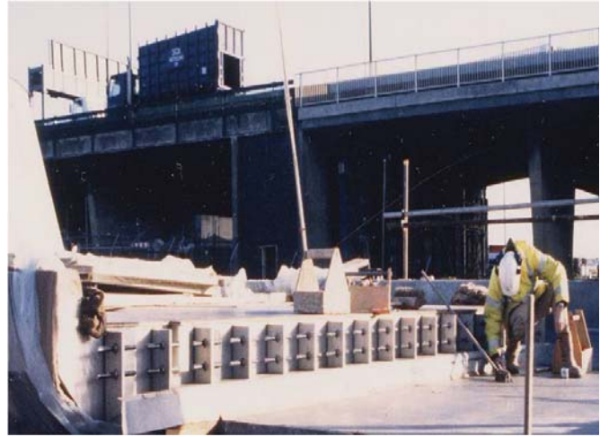
Dartford River Crossing 터널에는 제설제로 인한 부식을 방지하기 위해 스테인리스강 데크 조인트를 설치하였습니다.
